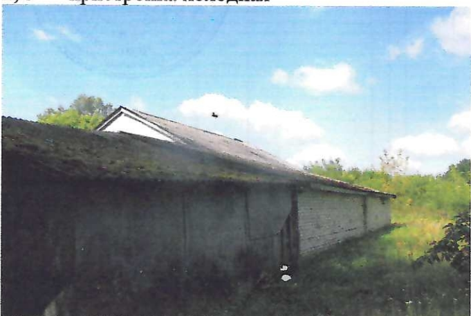
21.07.2023г., 2, 3, 4 — пристройка холодная
