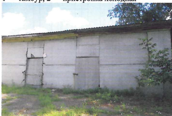
21.07.2023г., 3, 4 — пристройка холодная
